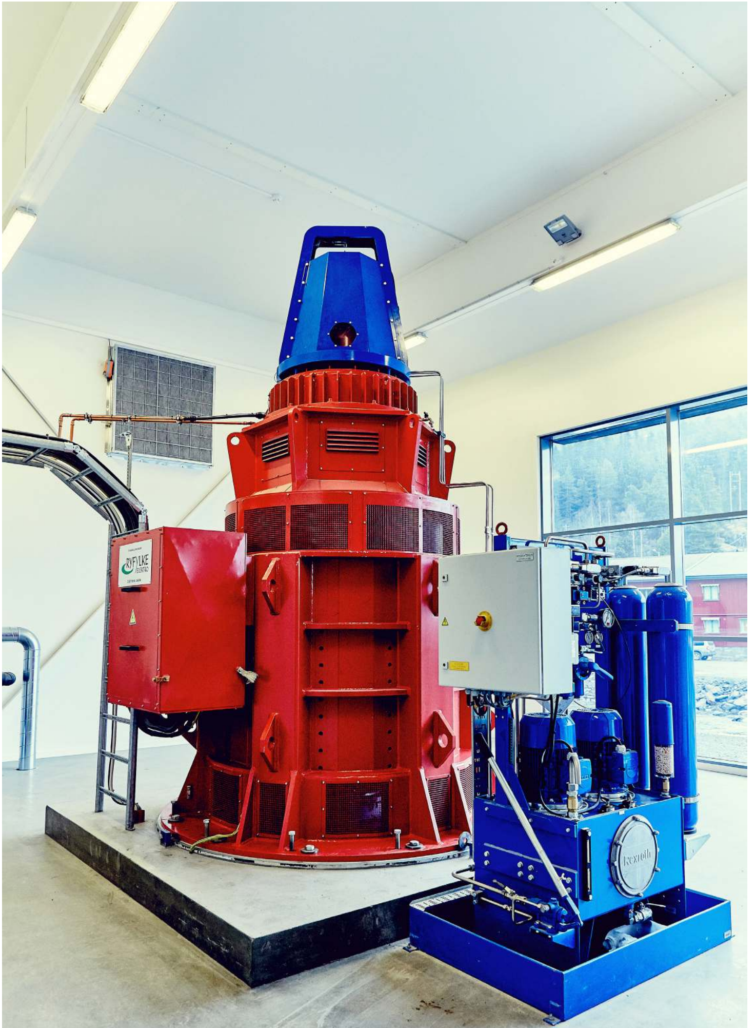
Turbin, Kvitvella Elektricitetsverk
